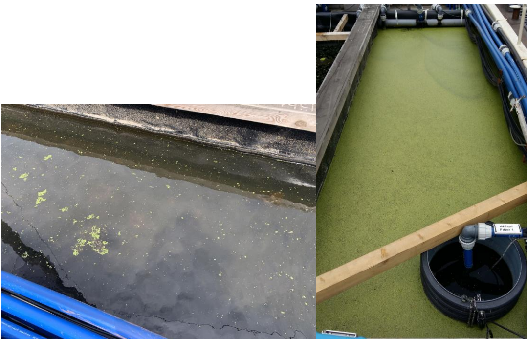
Abbildung 2: Überstau von Filter 1 am 08.06.2019, zwei Wochen nach Entnahme der Schwimmdecke aus Wasserlinsen links, am 05.07.19 mit neuer Schwimmdecke aus Wasserlinsen
