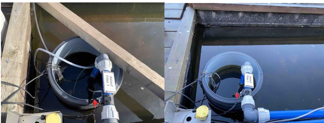
Abbildung 4: Überstau von Filter 1 am 06.10.2019, links, am 27.12.2019 rechts
